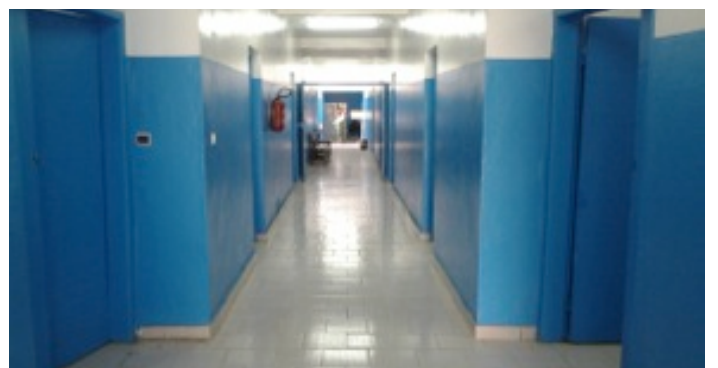
Couloir Gauche de la maternité du CSU de Sokoura réhabilité par la FATOM
